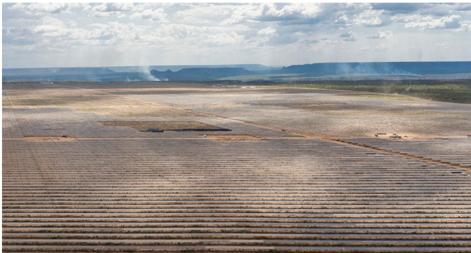
Figura 15: Il parco fotovoltaico di Enel a São Gonçalo
