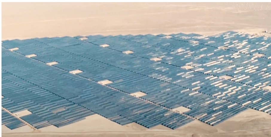
Figure 13 e 14: uno degli impianti fotovoltaici di Enel a Rubi, Perù (570 mila pannelli solari che coprono 400 ettari del deserto di Moquegua)
